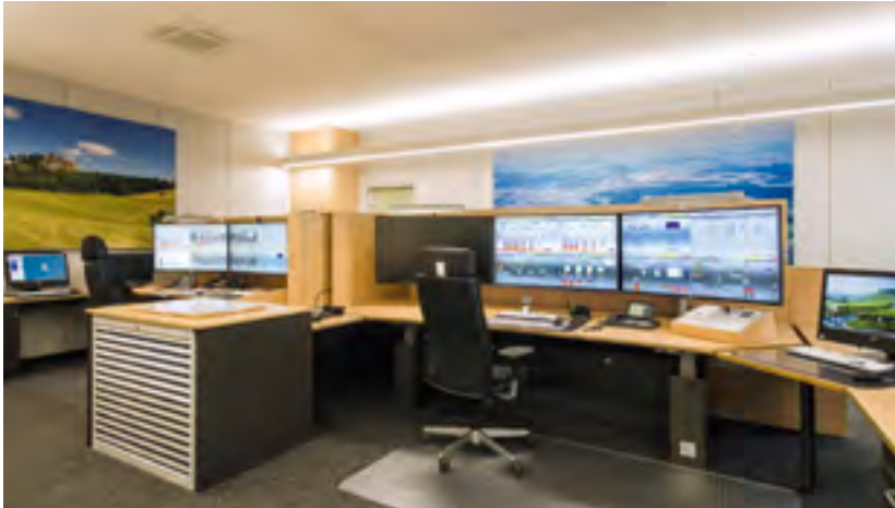
Thüga Energienetze hat ein neues Netzleitsystem eingeführt.
